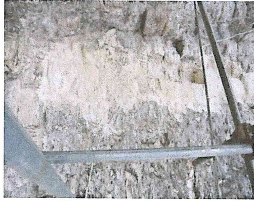
Grieta resanada en Templo III
